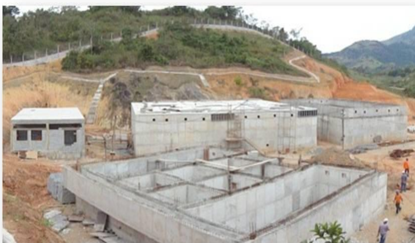
Figura 35 - Visão geral do ETE Serra Sede
